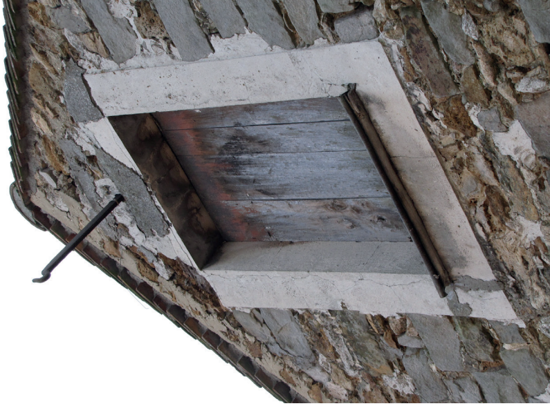
Porte à engranger, la potence métallique est encore en place.
