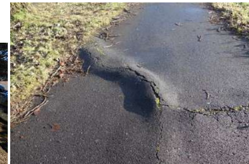
Racines d'arbres – inconfort voire chute.
