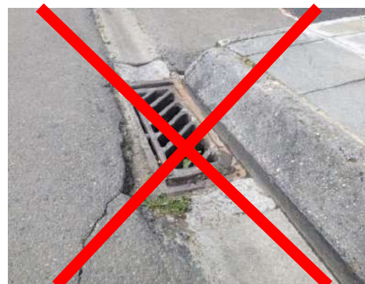
Avaloir dangereux Crédits photo : lejournalcatalan.com
