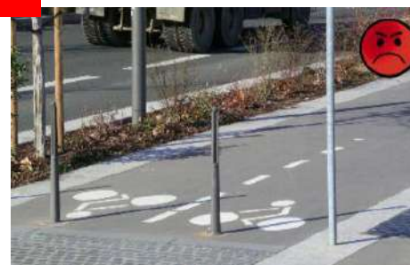
Disposition potelets dangereux Crédits photo : cerema.fr
