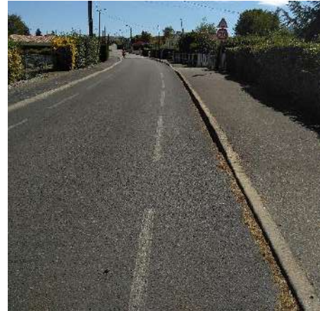
Peinture effacée – l'aménagement disparaît
