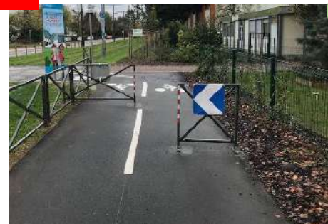
Barrières anti-intrusions dangereuses Crédits photo : robertsau.eu
